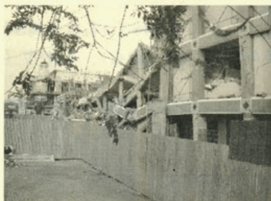
地震の被害を受けたビル
